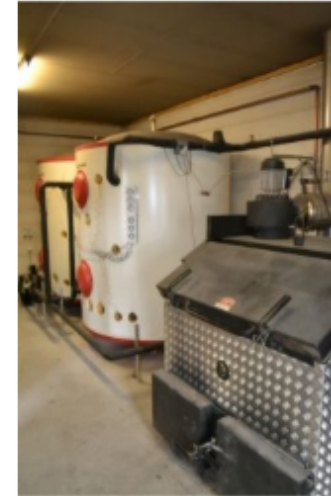
Akkumulatortank på 2 ganger 4000 liter
