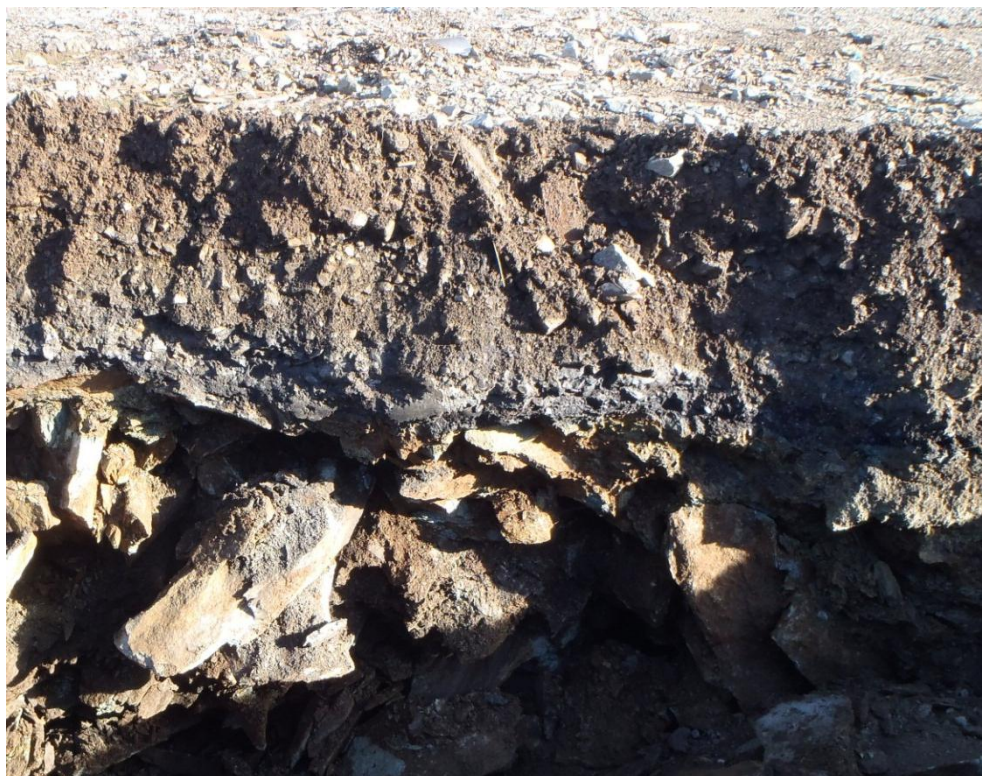
Figur 12: Sjakt 8. Over fyllmassene er det et tydelig mørkere lag av granulert asfalt, som igjen er overdekt med finere masser.
