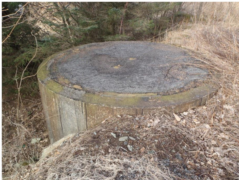
Figur 6: Overflateprøve OF 7. Betongfundament for oljetank, prøven ble tatt ved foten til venstre på bildet.
