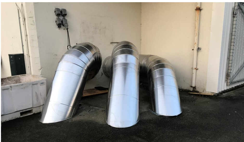
Figur 2. Rør tilkoblet sjøvannspumpene, etter isolering.
