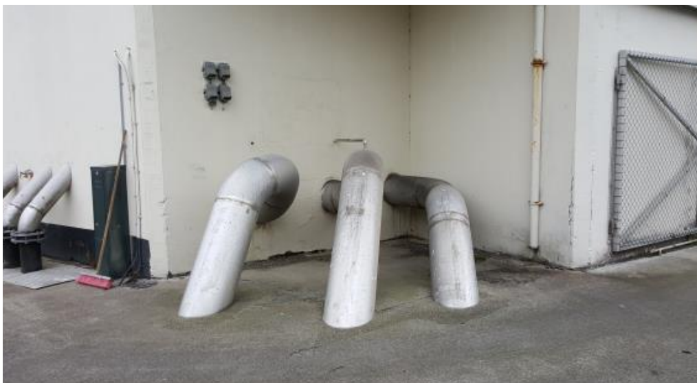
Figur 1. Rør tilkoblet sjøvannspumpene, før isolering.
