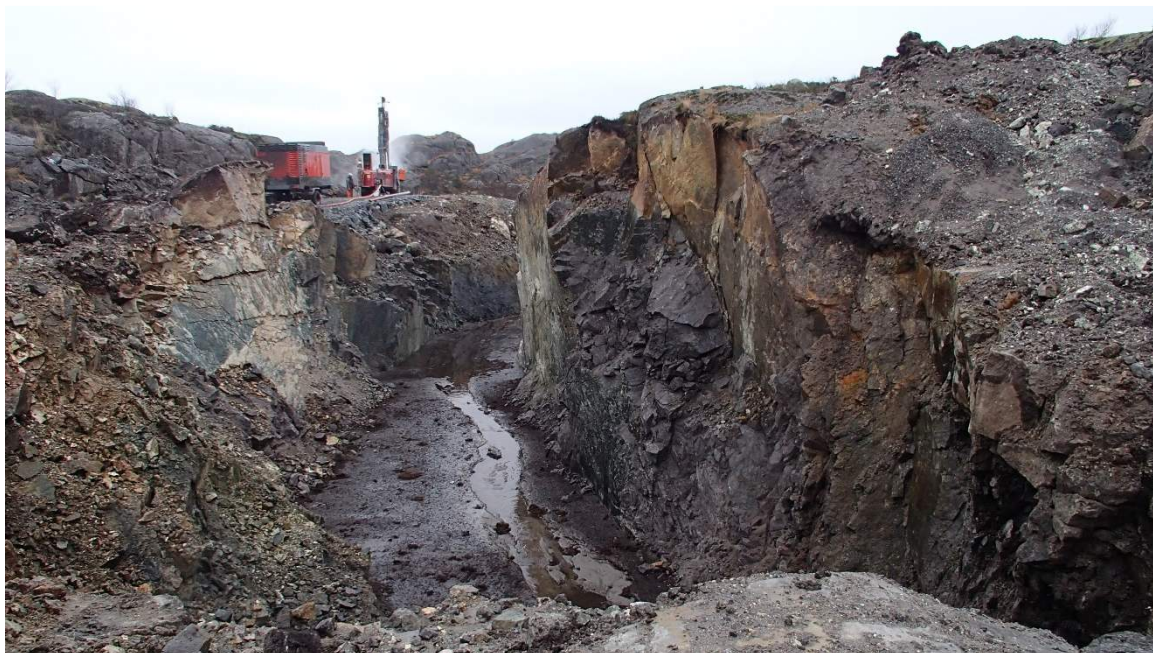
Figur 3 I lavpunktet hvor sigevannsledningen skal ligge, er det sprengt en grøft for å sikre best mulig drenering ut av deponiet (Foto: Arve Misund).
