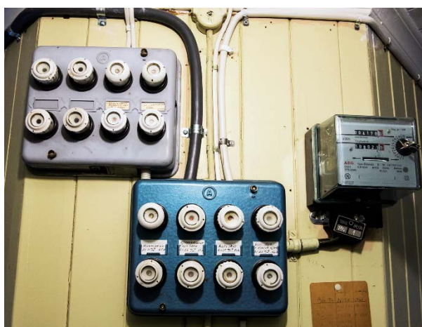
Bilde 22: Gammelt sikringsskap (Foto: Ove Sveinung Tennfjord/Randaberg kommune)
