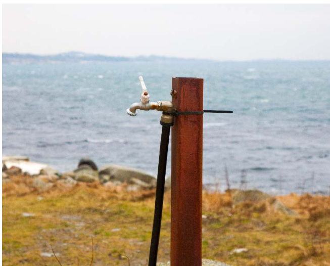
Bilde 19: Vasskran (Foto: Ove Sveinung Tennfjord/Randaberg kommune)
