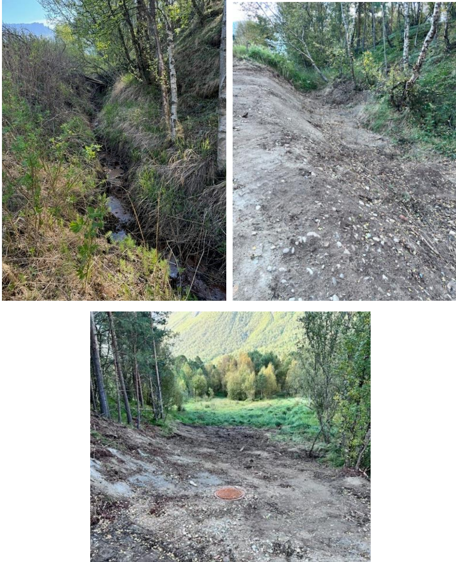
Figur 10 Tiltak 2024: Utsigsbekk til myr på motsatt side av miljøbrønn 3 er stoppet og lagt i rør til kum. Nye vannprøver her kan analyseres.
