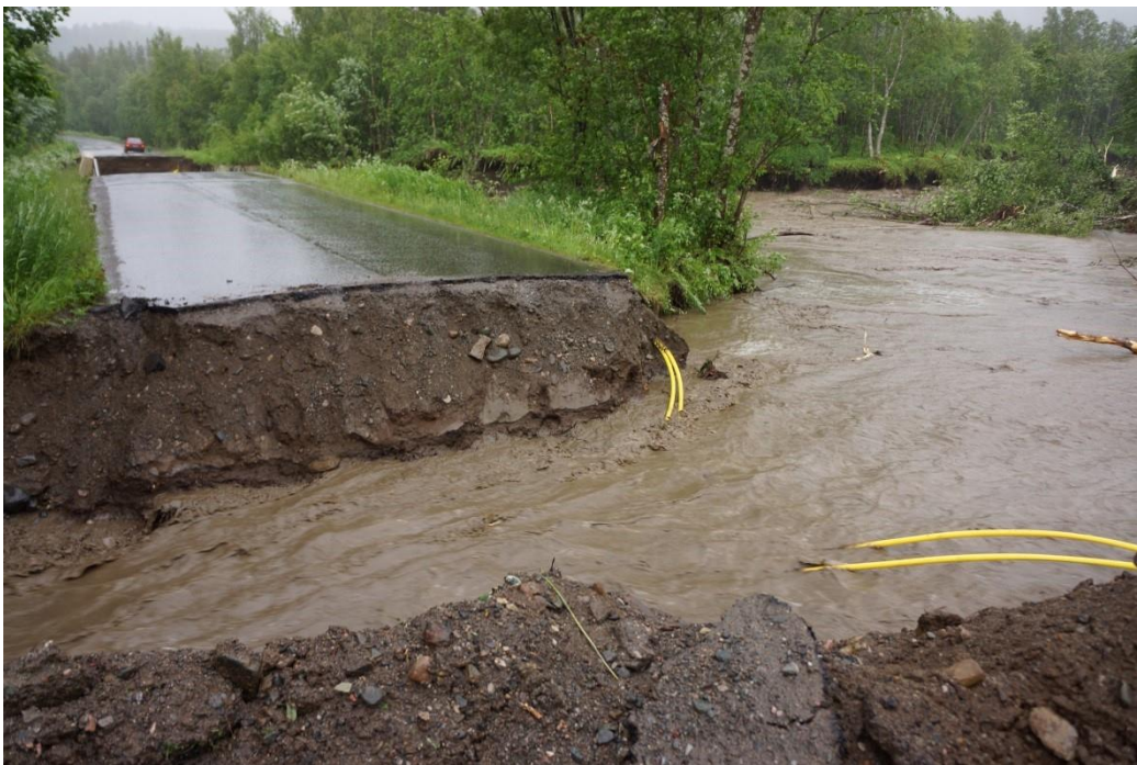
Bilde av veibrudd i Målselv i 2012 hvor kabler ble revet av. Foto Ole Asheim
