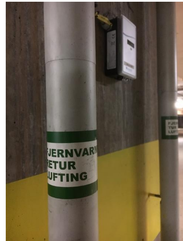
Fjernvarmerør. Foto: Miljødirektoratet
