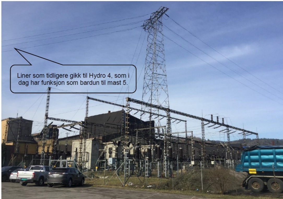
Bilde 1: Dagens mast nr. 5 i Roligheten transformatorstasjon.
